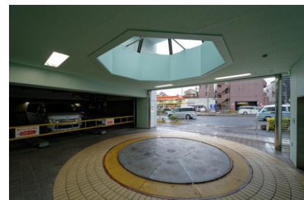
機械式駐車場
