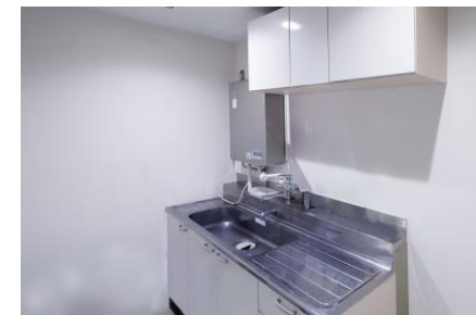
基準階共用給湯室
